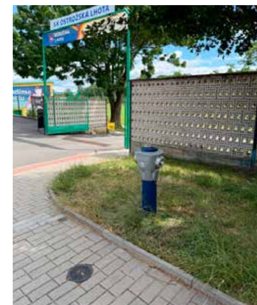
Nový nadzemní hydrant.
