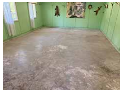
Podlaha myslivecké chaty před opravou
