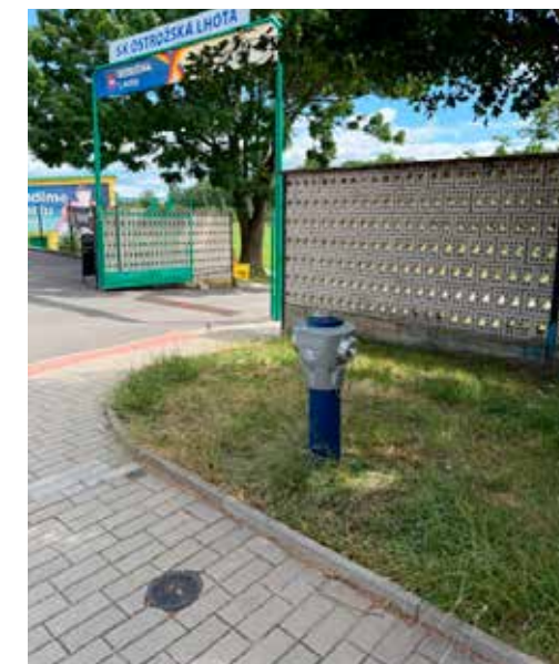
Nový nadzemní hydrant.
