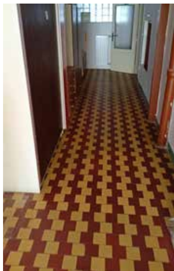
Podlaha v MŠ před rekonstrukcí
